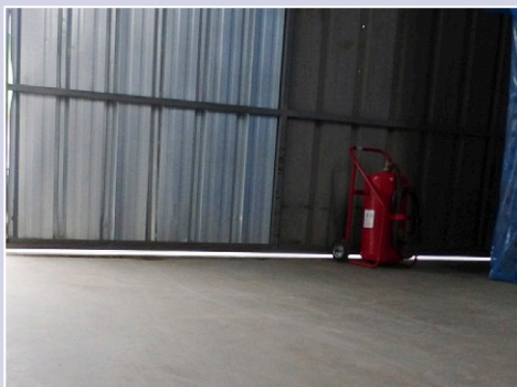
La falta de sello inferior en las puertas de corredera, hace posible la entrada de roedores.
