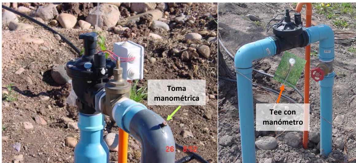
Foto 2. Izquierda: Toma manométrica para laterales de polietileno. Derecha: tee de polietileno insertada en la línea de riego, para colocación de manómetro cuando no hay toma manométrica.
