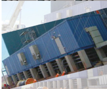
DIVISIÓN SALAS ELÉCTRICAS
